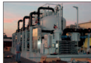
带 6.18型（过滤精度 50 μm）波尔自动滤器的采出水单元
