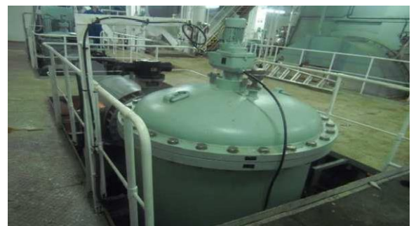
Imagen 3: BOLLFILTER Automático de Tipo 6.18.3 instalado
