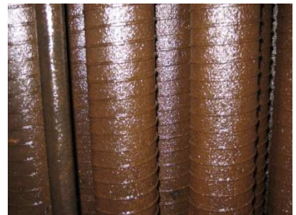
Bild 2: mit Belag verschmutzte Filterelemente
